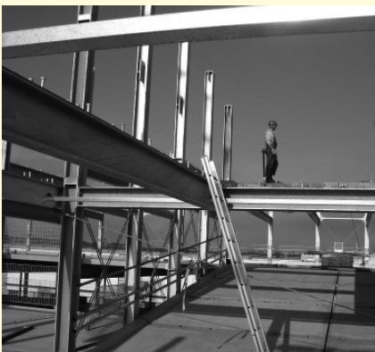
Abb. 1: Ein Höhensicherungsgerät würde keinen wirksamen Schutz gegen Absturz bieten.
