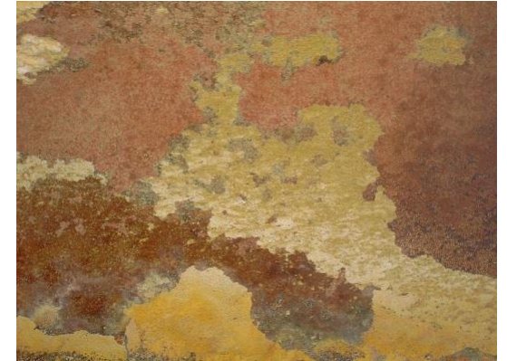
Bild 1: Beschädigte Oberfläche Staubbehälter.
