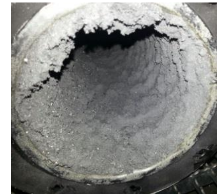
Bild 4: Brennbare Ablagerungen in Rohrleitung
