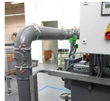
Bild 3: Erdungsbeispiel Rohrleitung & Kontrollöffnung Quelle: CHIRON-WERKE
