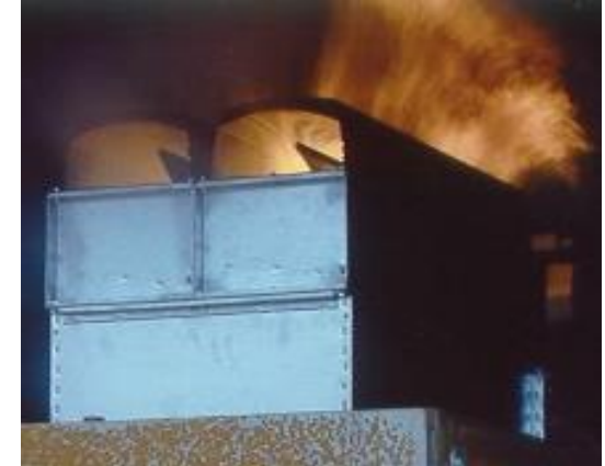
Bild 1: Druckentlastung WZM ohne wirksame Flammensperre.
