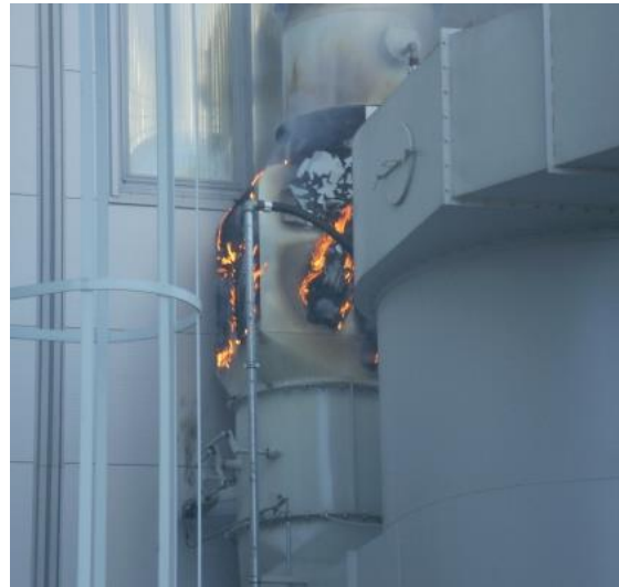
Bild 1: Brand in Abluftleitung
