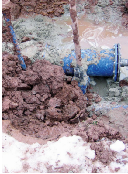
Der Graben ist durch Witterungseinflüsse teilweise eingestürzt.
